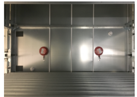
Rauchansaugsystem zur Detektion:
